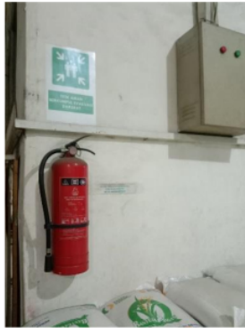
Gambar 2.a.2 Alat pemadam kebakaran/Apar
